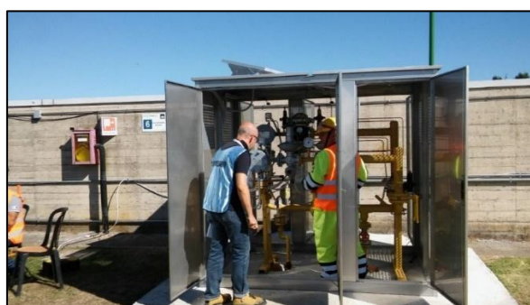
Manutenzione su gruppo di riduzione gas
