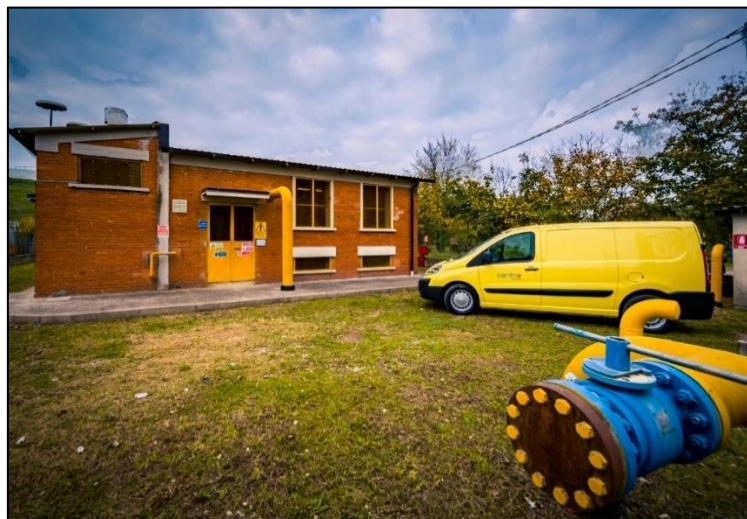
Esterno Cabina REMI (Regolazione e Misura)
